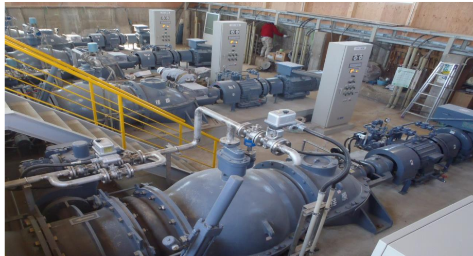
手前が増設4号機 Front : Additional pump
