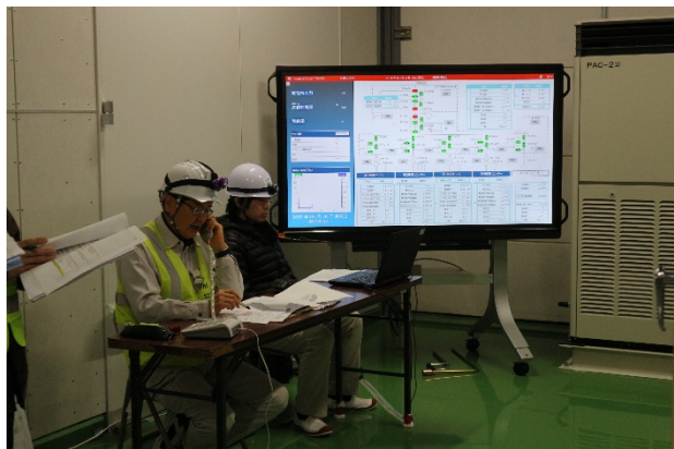
受電確認 中国電力に確認
