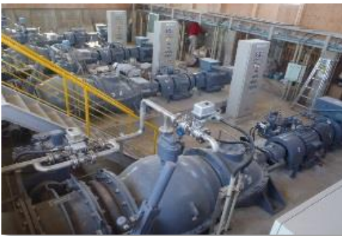
2016 年 3 月【安全安心事業】 瀬戸内市との施行協定に基づく予備排水ポン プ設置工事と非常用発電機新設 工事完了
