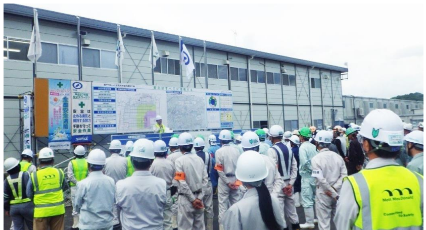
瀬戸内 Kirei 太陽光発電所建設サイトで行われた安全大会
