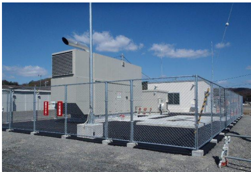
非常用発電機(手前)及び新電気室(奥)
