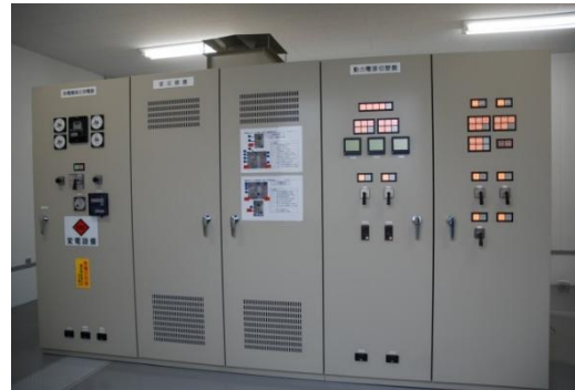
新電気室(内部)
