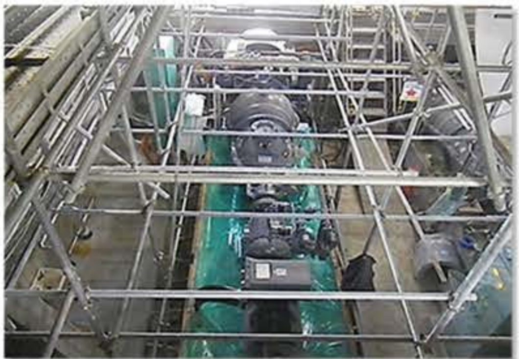
新たに増設した4台目のポンプです。
