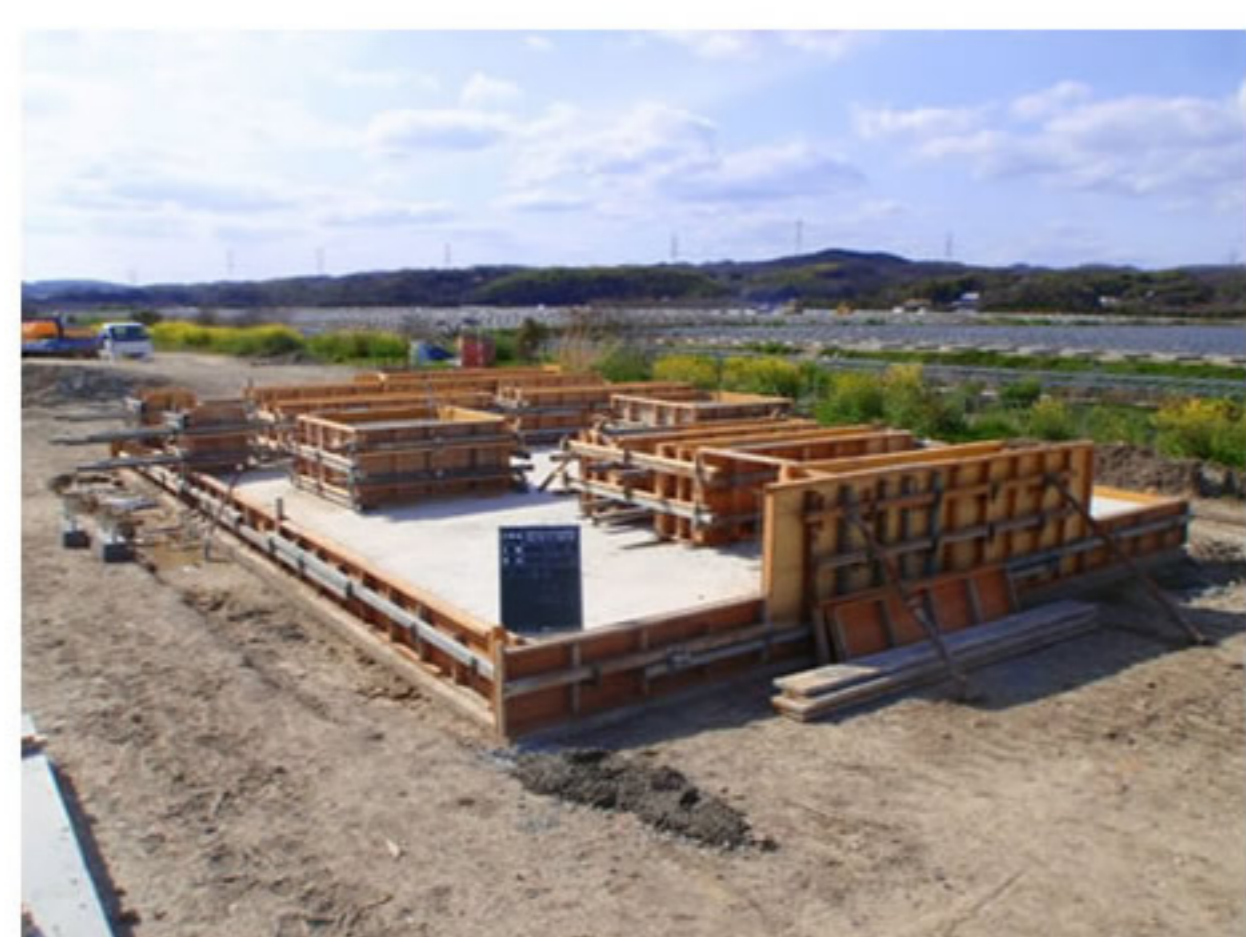
⑪ パワーコンディショナー等を乗せる部分の型枠を組立て、さらにコンクリートを打ちます
