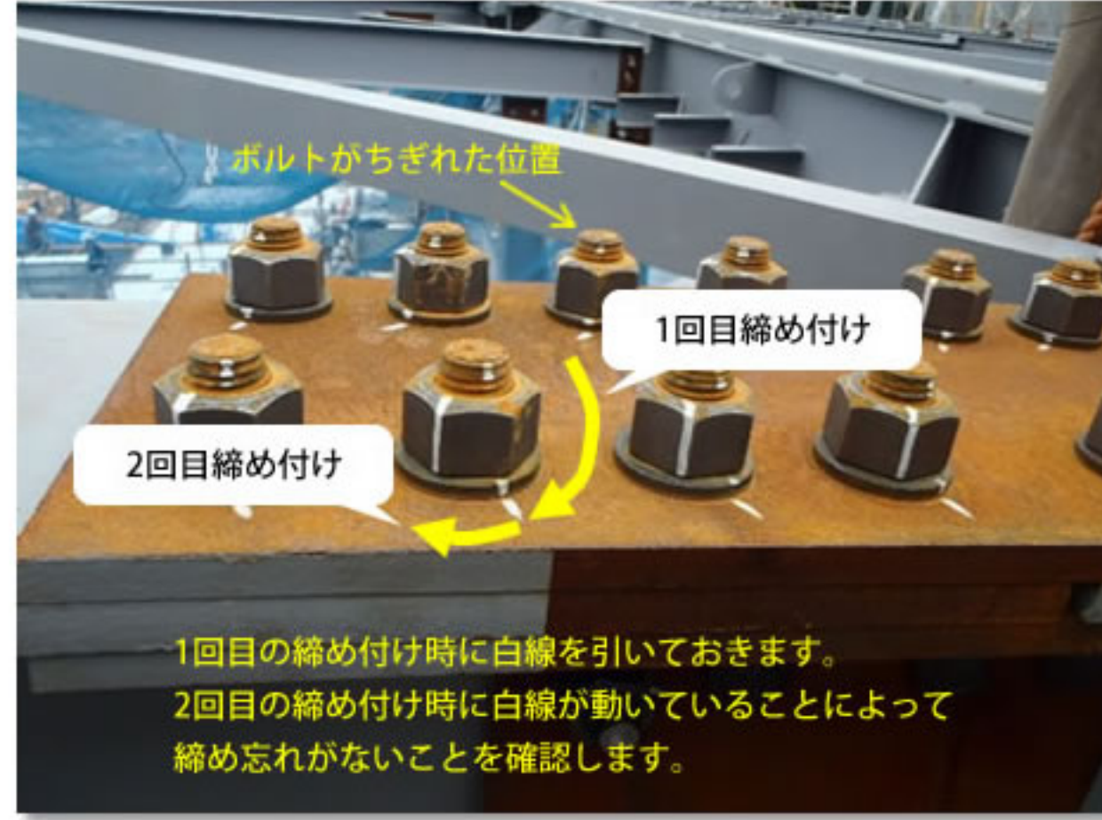
⑦ 締め付け後に、ボルトがちぎれた様子
