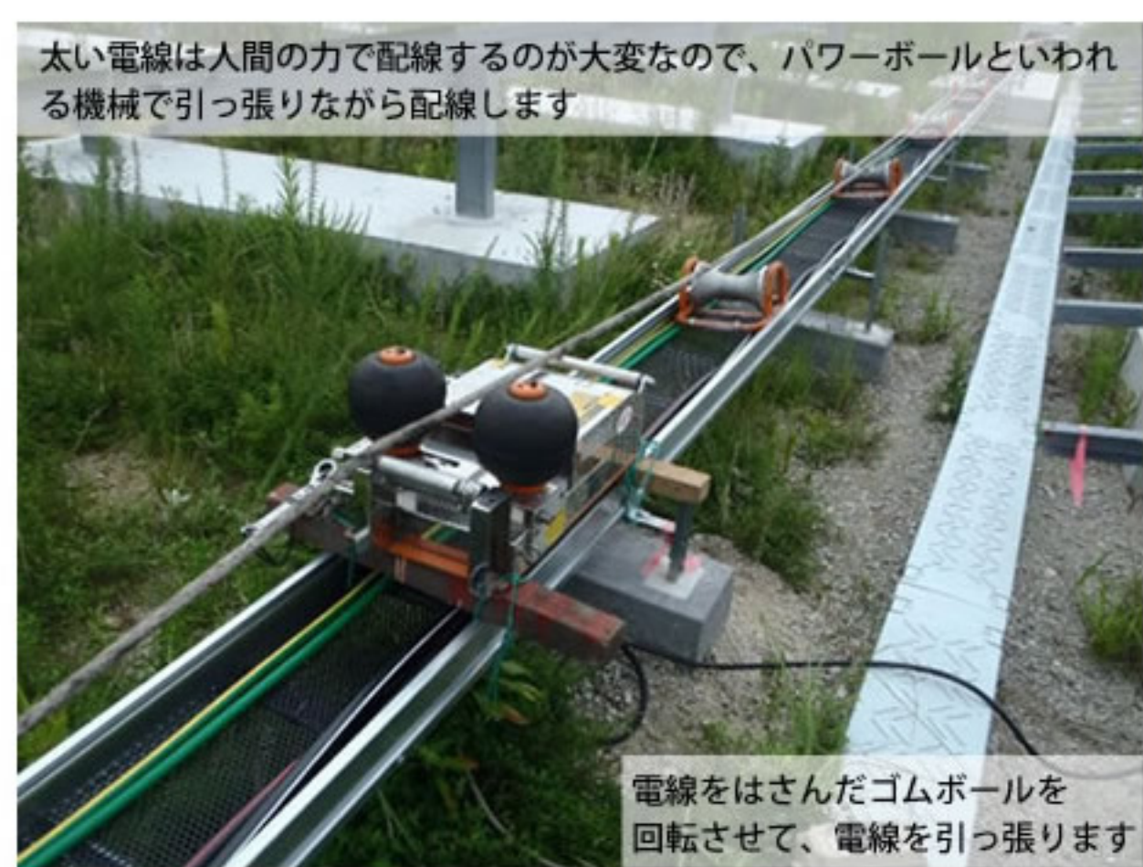
⑧ 配線状況
